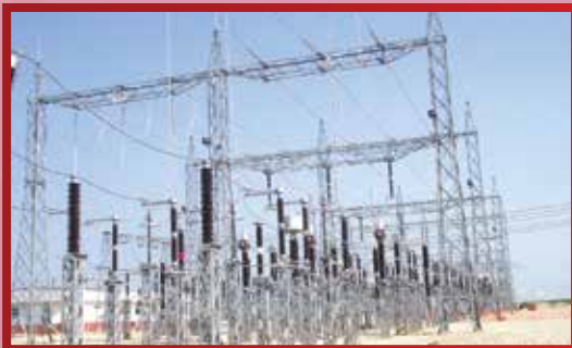
Manutenção de Sistemas de Energias em OMCs
